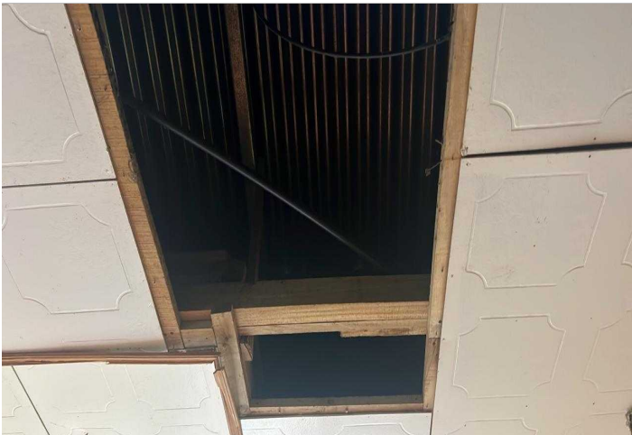
Descripción: PIEZAS DE CIELO RASO SUSTRIDAS
