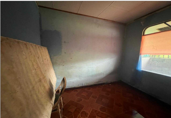
Descripción: 2DO .DOMITORIO CON PROBLEMAS SERIOS DE HUMEDAD, AGUA ESTANCADA
