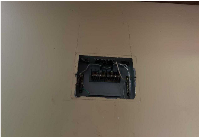
Descripción: CAJA DE BREAKER
