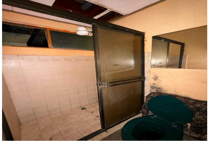
Descripción: SERVICIO SANITARIO
