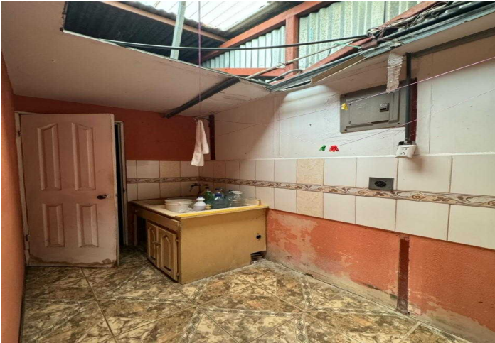
Descripción: CUARTO DE PILAS
