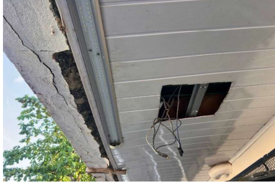
aleros - sistema eléctrico sin entubar
