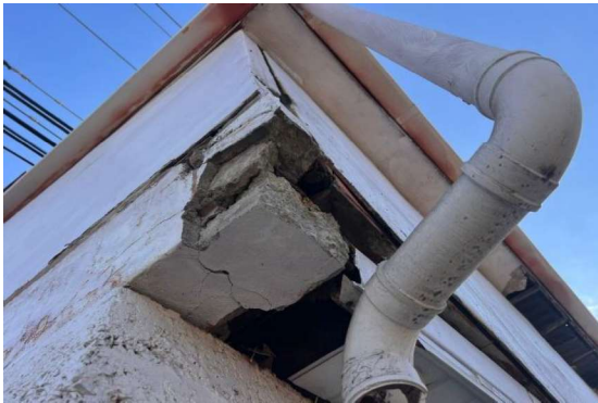
canoas y bajantes , problema estructural
