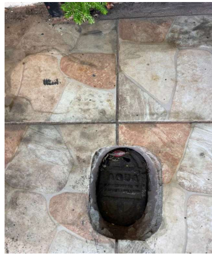
medidor de agua
