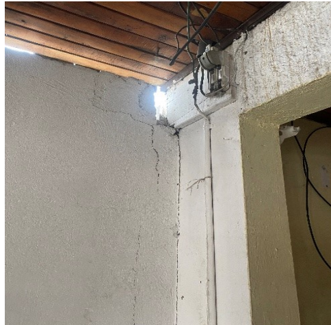
CUCHILLA Y GRIETA PARED
