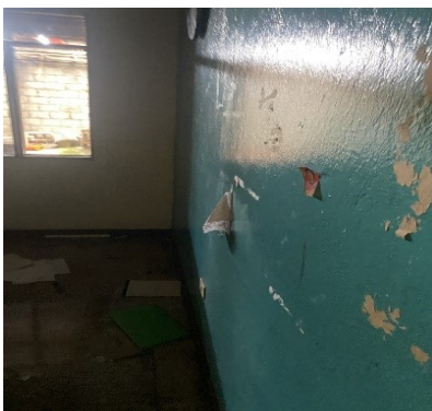
PARED CON PAREDES CON DAÑOS EN
