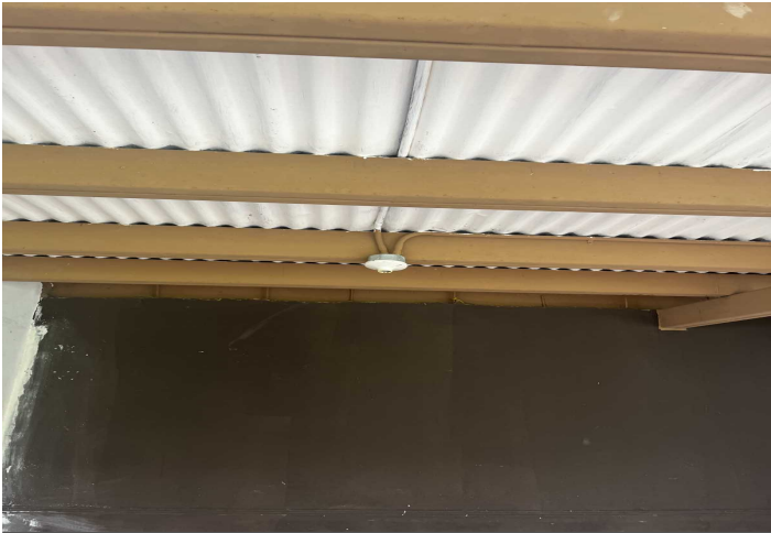
Descripción: Instalación eléctrica de apartamento
