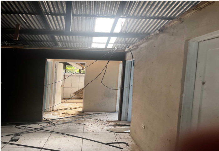
Descripción: Estado de cielos e instalación eléctrica
