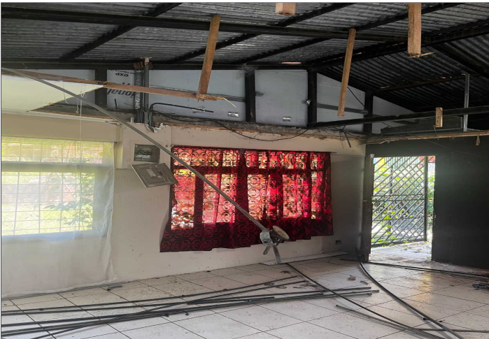
Descripción: Estado actual de caja de breaker de vivienda
