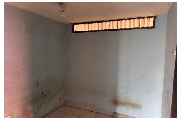
DORMITORIO (HUMEDAD EN PAREDES)
