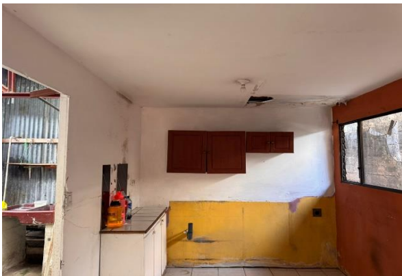
COCINA (HUMEDAD EN PAREDES)
