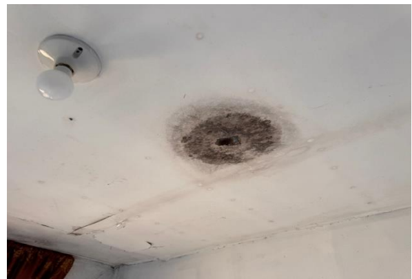
HUMEDAD EN CIELOS
