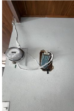
Sistema electrico, acometida sin entubar en medidor
