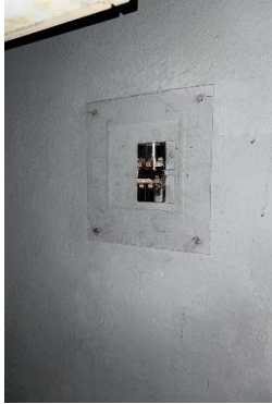
Sistema electrico, caja de breakers en funcionamiento
