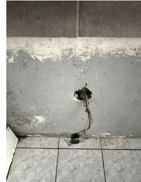
Sistema electrico, tomacorriente desprendido
