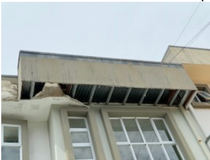
Estado alero fachada principal
