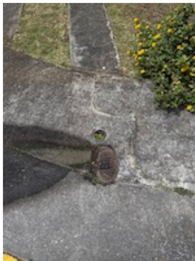
Conexión agua potable (sin servicio conectado)
