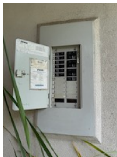
Centro de carga
