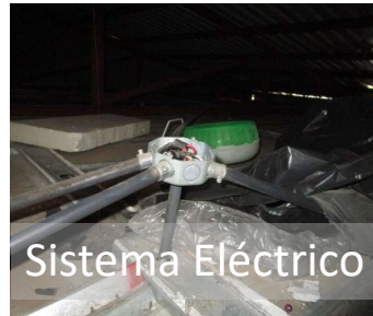
Caja de Breakers (Sin Breakers ni Tapa)
