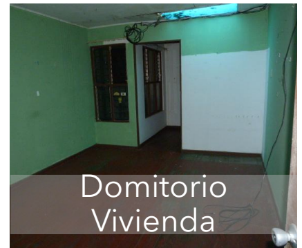
Cielo raso mal estado en Vivienda
