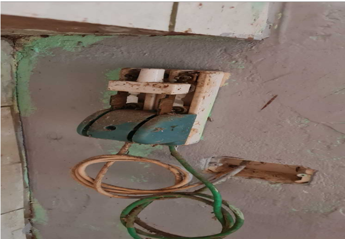
Descripción: INSTALACIONES ELÉCTRICAS
