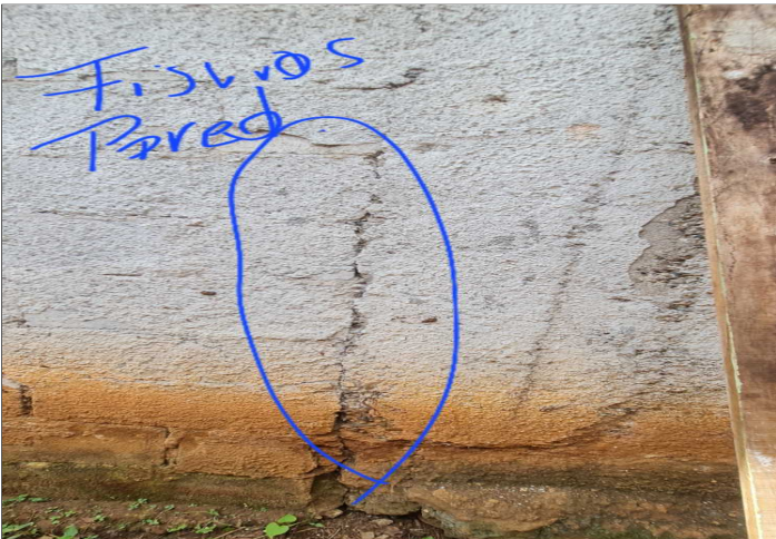
Descripción: FISURAS EN PAREDES
