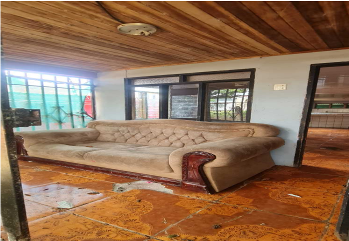
Descripción: ACCESO Y CORREDOR , DAÑOS EN PISO CERÁMICO
