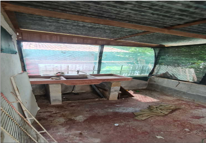
Descripción: CUARTO DE PILAS
