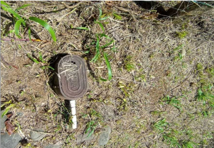
Descripción: Medidor de agua potable
