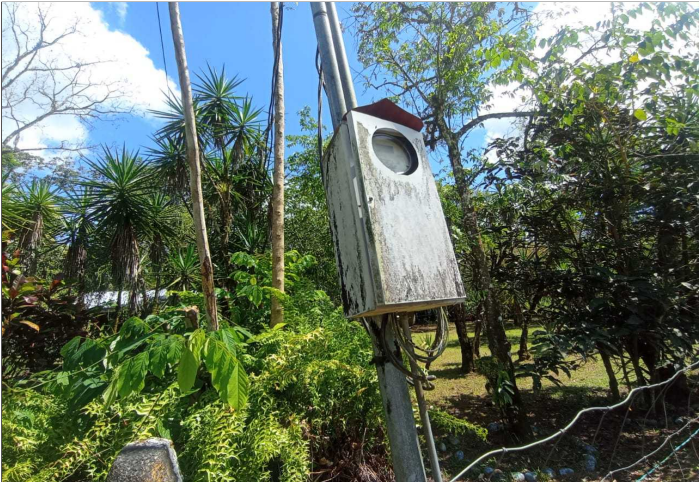
Descripción: Medidor de fluido eléctrico
