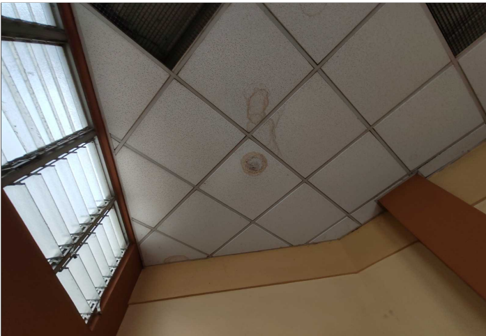
Descripción: DAÑOS. CIELO RASO CON HUMEDAD
