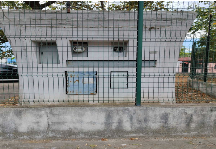
Descripción: MEDIDOR DE ELECTRICIDAD
