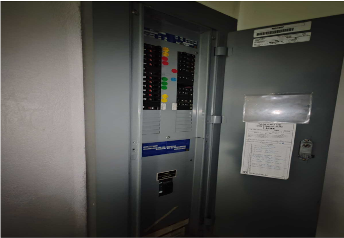
Descripción: CAJA DE BREAKER
