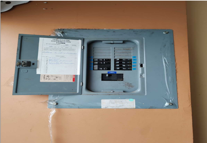
Descripción: CAJA DE BREAKER SEGUNDO NIVEL
