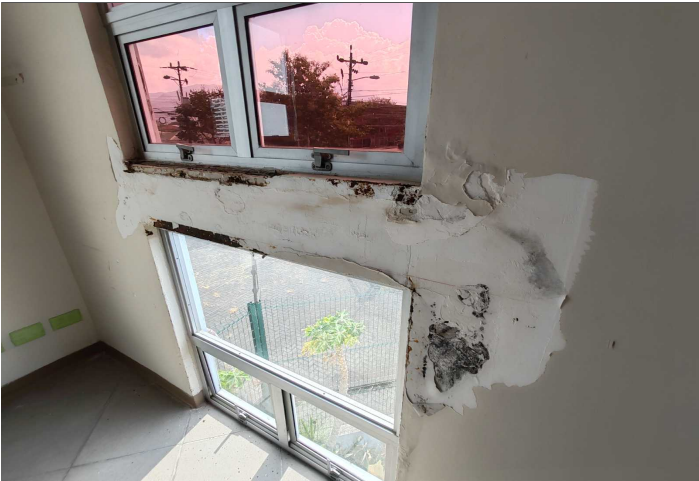
Descripción: PAREDES CON REPELLO DESPRENDIDO Y FALTA DE PINTURA.
