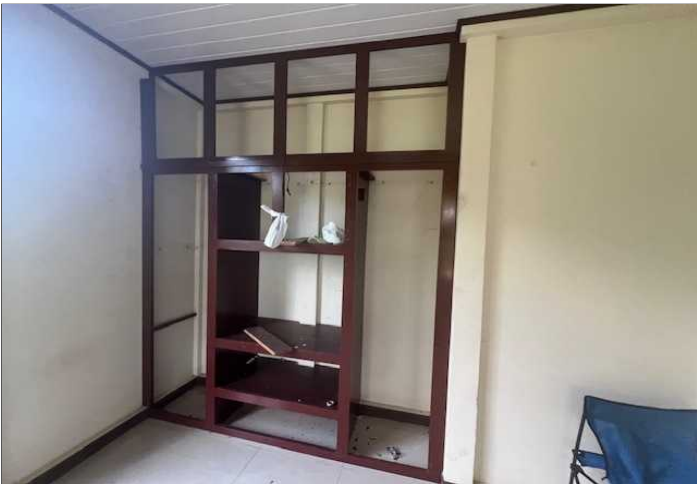
Descripción: Closet dañado
