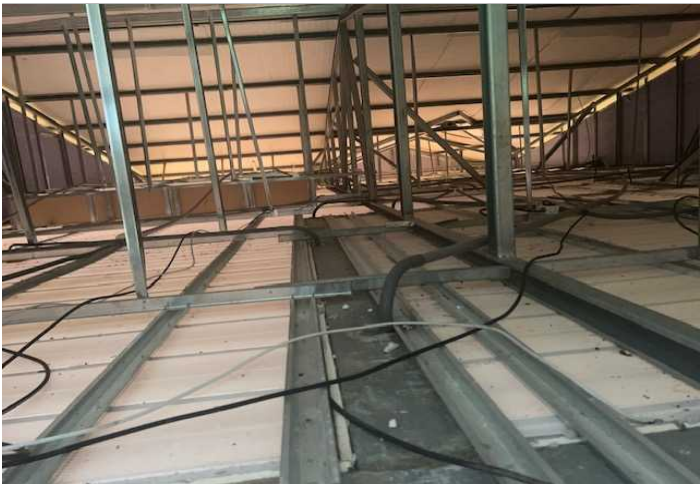
Descripción: Vista del sistema eléctrico
