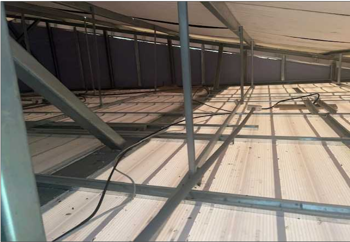
Descripción: Vista sistema eléctrico
