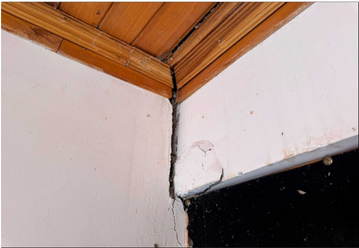
Descripción: fisura en la unión de pared de dormitorio principal
