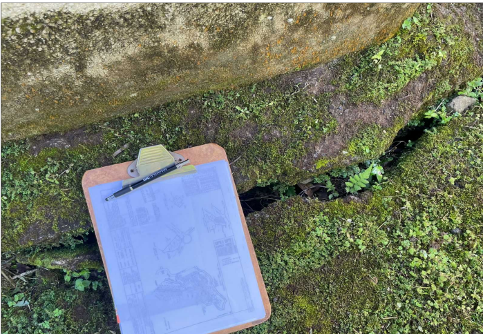
Descripción: MOVIMIENTO DE MASA EN ÁREA DE ZONA DE PROTECCIÓN Y TAPIA
