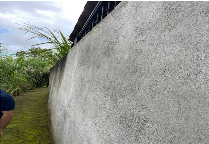
Descripción: DESPLOME DE PAREDES
