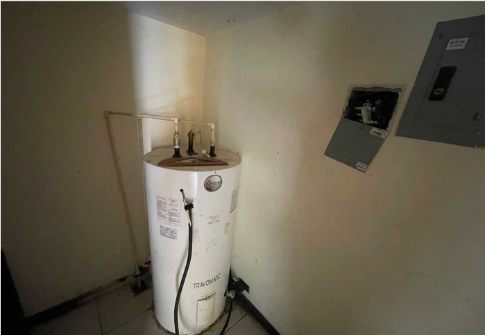
Descripción: BODEGA (TANQUE AGUA CALIENTE)
