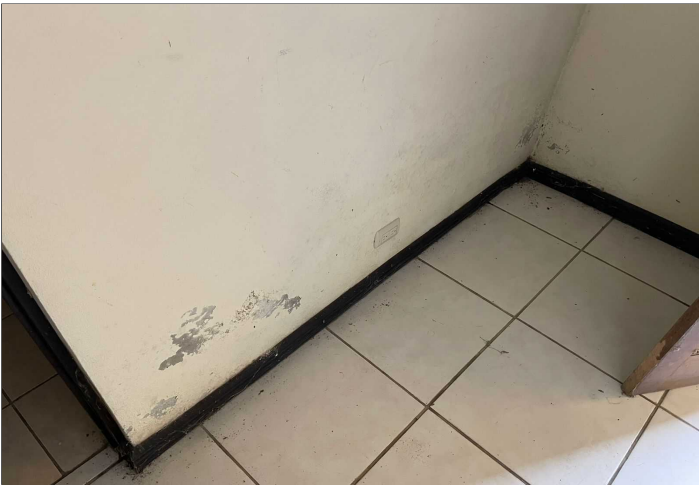
Descripción: HUMEDAD EN PAREDES
