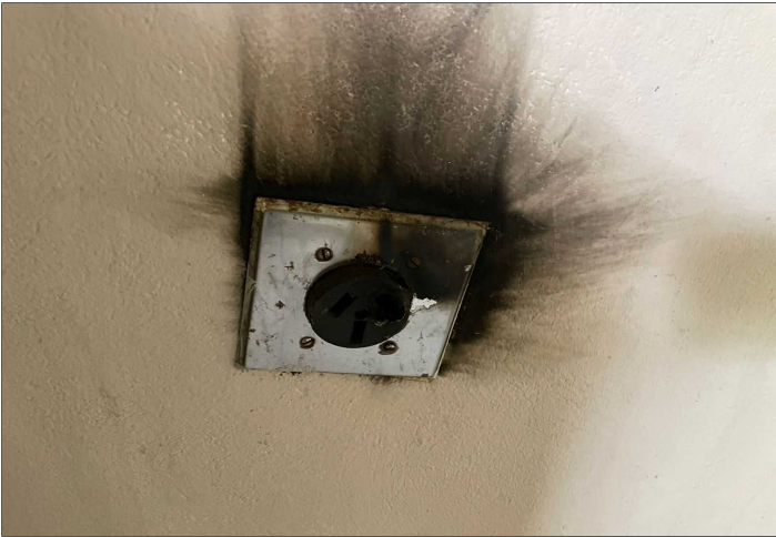
Descripción: DAÑOS ELECTRICOS
