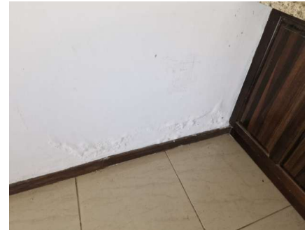
42 Humedad en paredes
