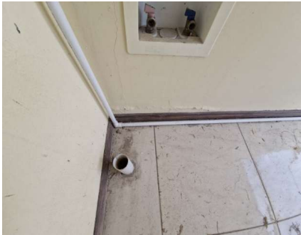
61 Humedad en paredes
