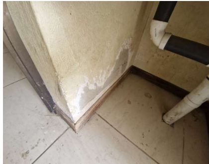
62 Humedad en paredes
