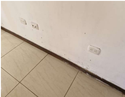
43 Humedad en paredes
