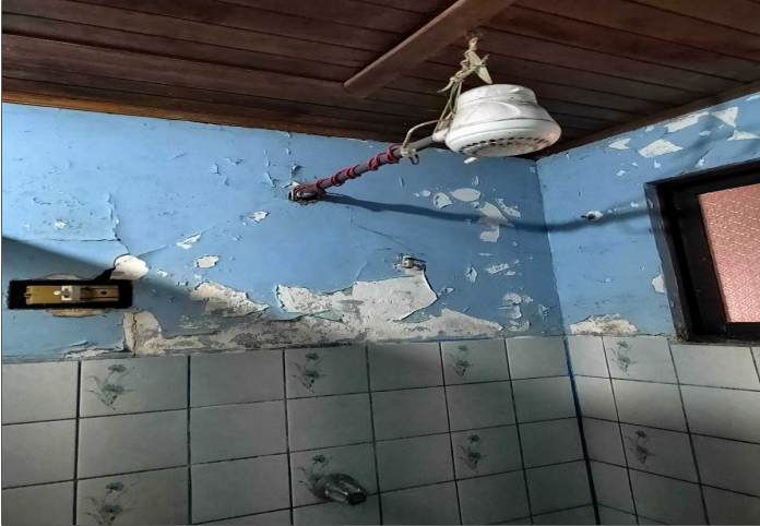
Descripción: Ducha, interruptor de cuchilla en pared. Paredes con deterioro de pintura
