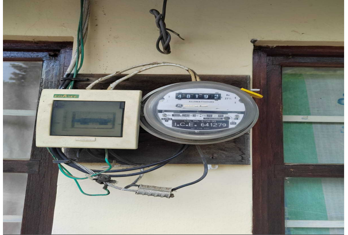
Descripción: Medidor. Actualmente en uso
