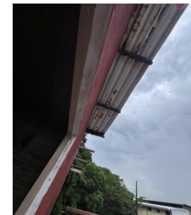
ALEROS CON CORROSIÓN
