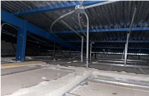
Parte del sistema eléctrico
