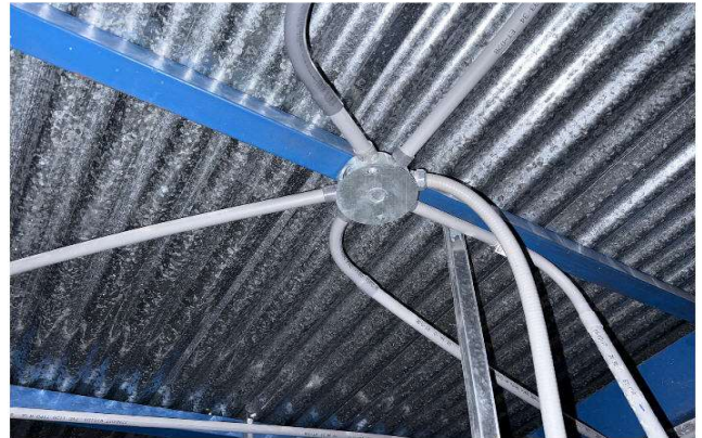
Parte del sistema eléctrico
