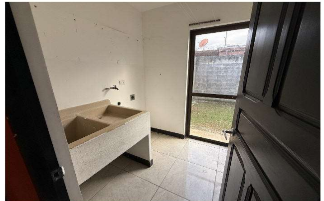
Área de pilas
