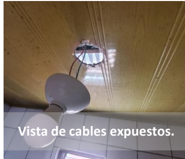
Vista de cables expuestos.
