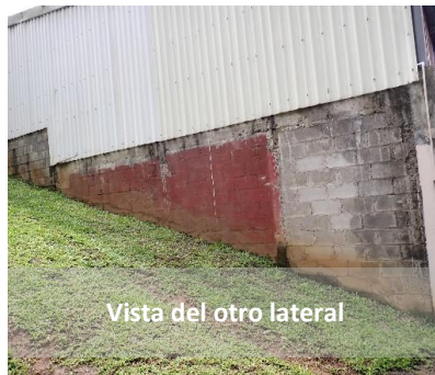
Vista lateral con problemas en cimientos
