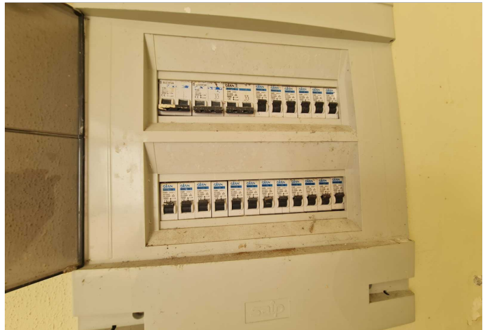
Descripción: CENTRO DE CARGA ELÉCTRICA
