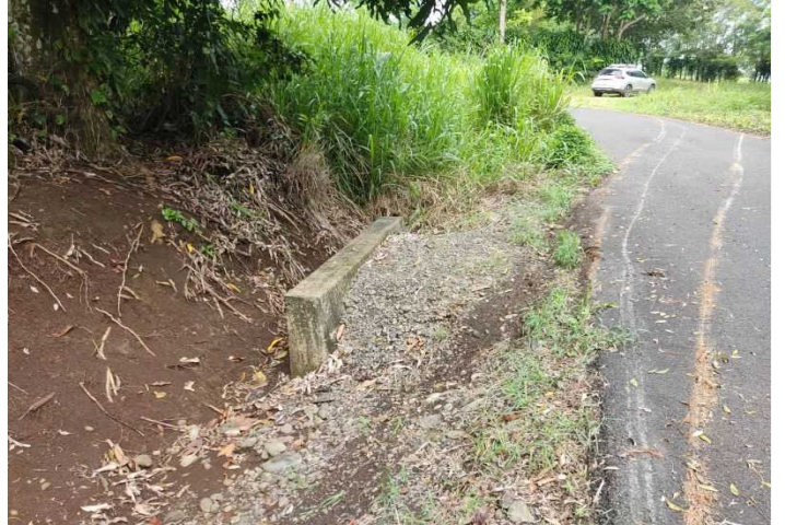
Descripción: Detalle de caño natural en el lindero Este con alcantarilla de aguas pluviales
