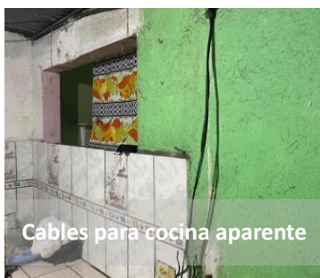
Parte sistema electrico de la casa
