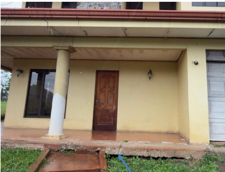
Vsta espacio socabado o erosionado del suelo bajo contrapiso de corredor en entrada de la casa, causando fisuras importantes.
