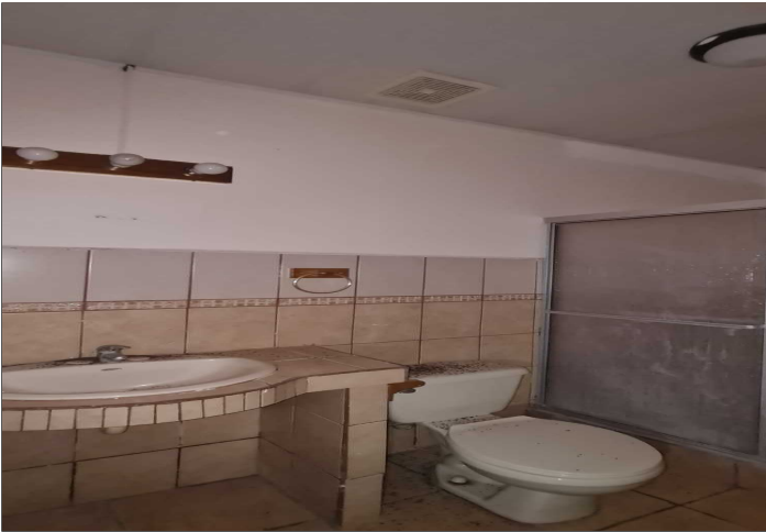
Descripción: Servicios sanitarios
