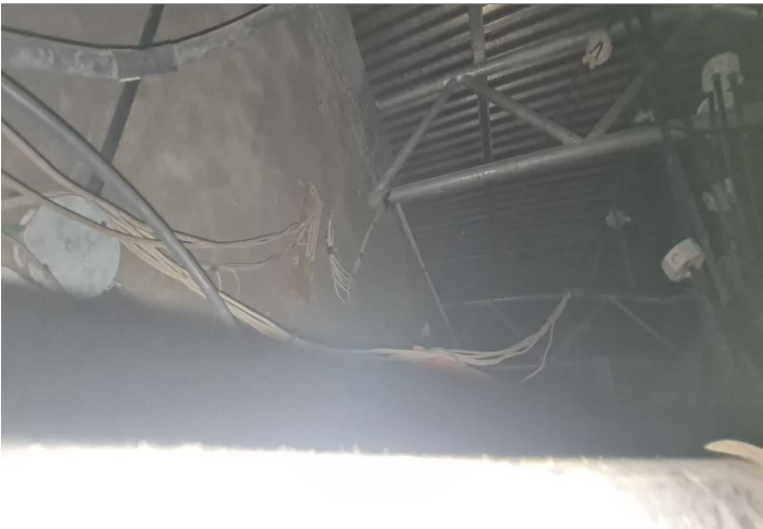
Descripción: Conexiones en cielo raso
