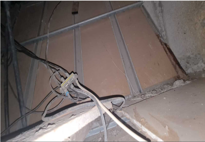
Descripción: Conexiones en cielo raso
