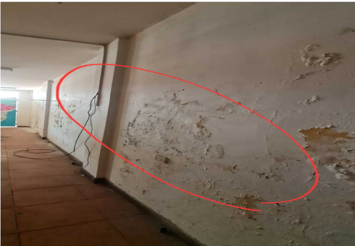
Descripción: Humedad en paredes
