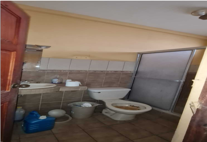
Descripción: Servicios sanitarios
