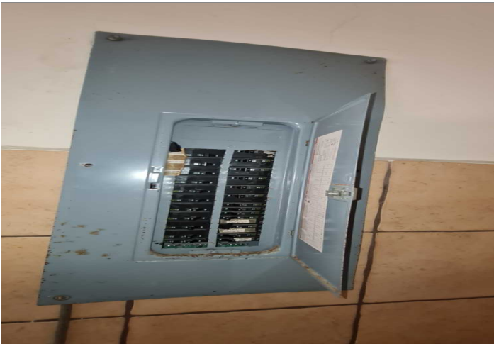
Descripción: Tableros eléctricos
