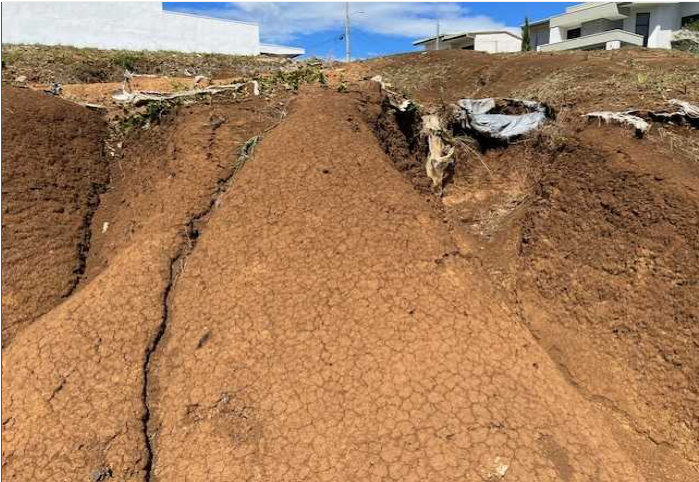
Descripción: LOTE CON SOCAVACIÓN POR ESCORRENTÍA DE AGUAS SUPERFICIALES - MALA CANAL
