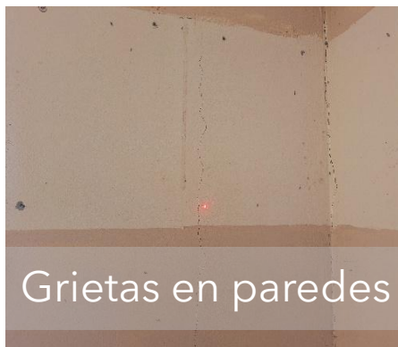
Grietas en paredes
