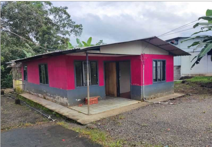
Descripción: Vista de casa de madera con zócalo en mal estado (no valorada)
