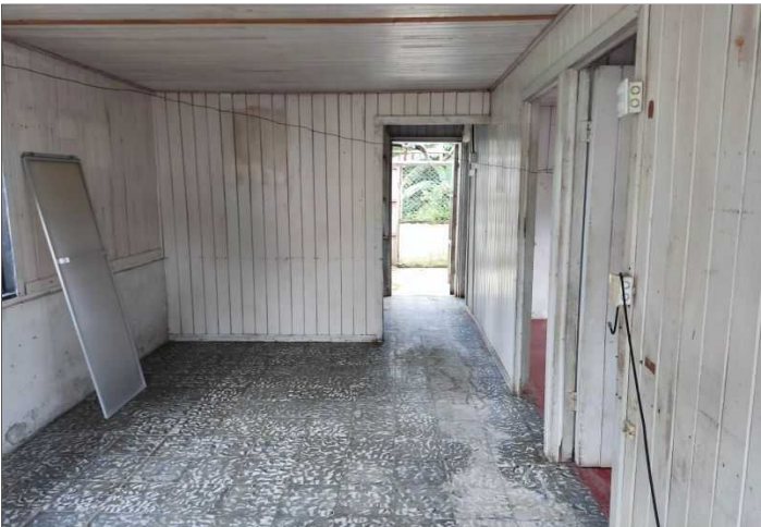
Descripción: Vista interior de la casa de madera en mal estado
