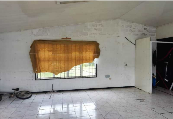
Descripción: Paredes internas, repellos, cielos y pisos con daños o falta mantenimiento
