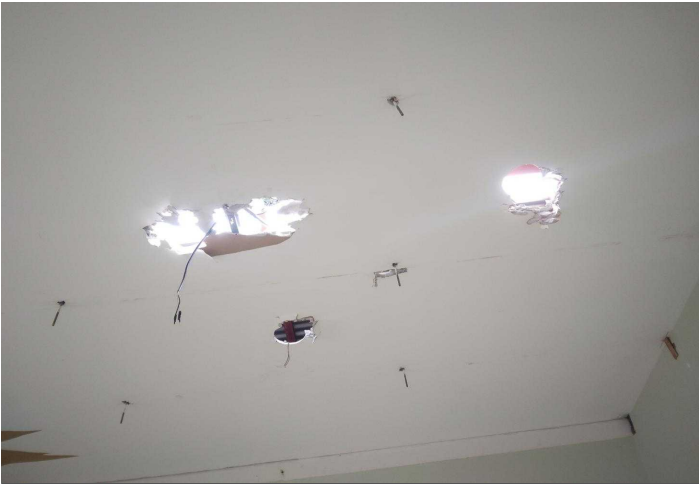
Descripción: Daños en cielos, remoción de luminarias, sistema eléctrico y lámina de zinc
