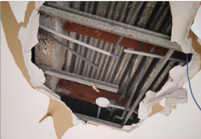
Descripción: Daños en cielos y sistema eléctrico
