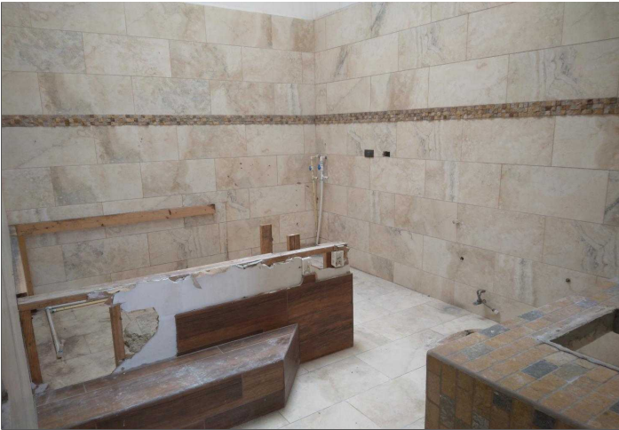
Descripción: Baño principal vandalizado
