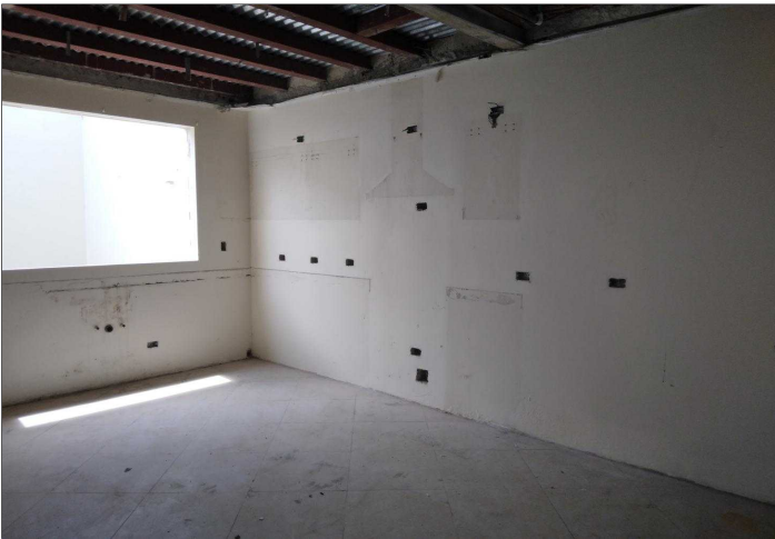
Descripción: Cocina vandalizada
