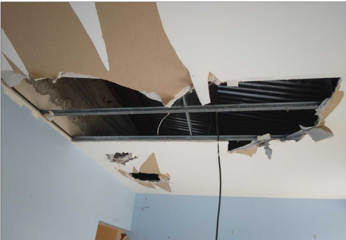
Descripción: Daños en cielos
