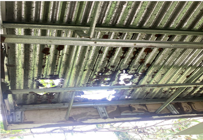
Descripción: CUBIERTA DE ALERO EN MAL ESTADO
