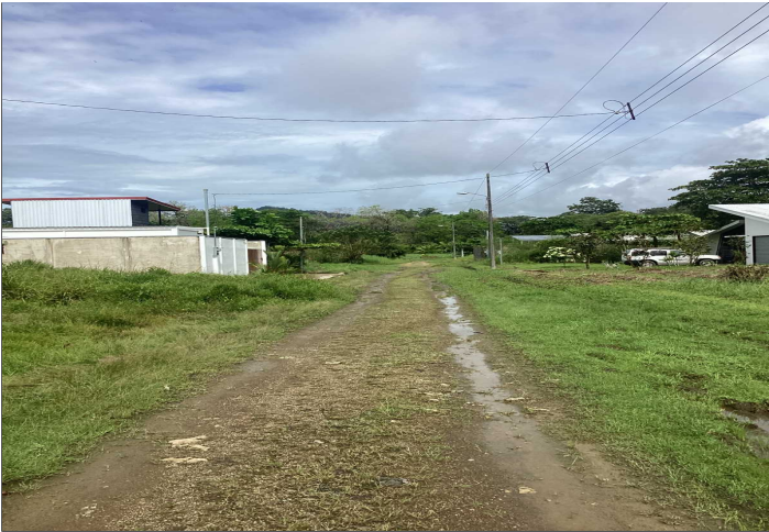
Descripción: CALLE DE LA URBANIZACIÓN MAL ESTADO
