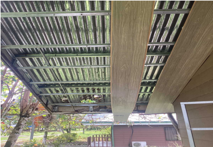
Descripción: CIELO RASO DE ALERO FRONTAL DAÑADO Y CUBIERTA DAÑADA POR OXIDACIÓN
