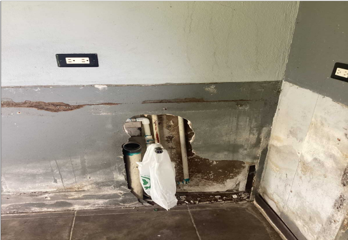
Descripción: MUEBLE DE COCINA DESPRENDIDO GENERANDO UN DAÑO A LA PARED
