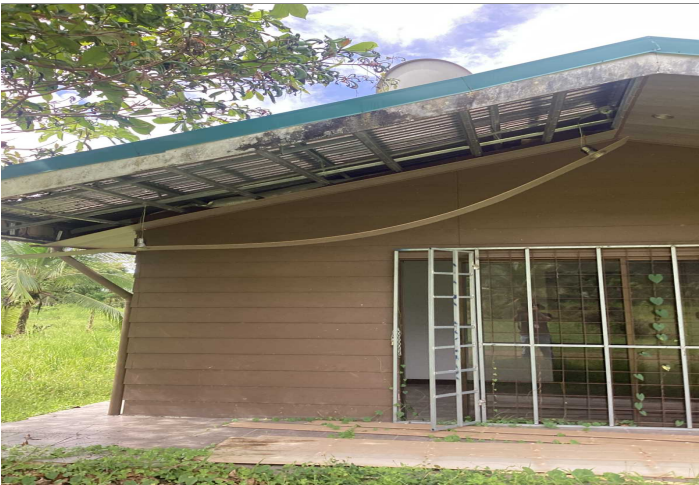
Descripción: ALERO Y CUBIERTA EN MAL ESTADO
