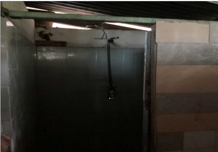
Descripción: BAÑO EN MAL ESTADO
