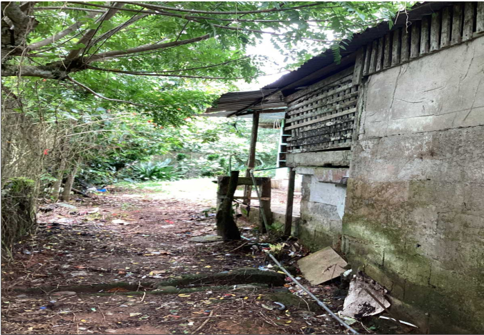
Descripción: FACHADA POSTERIOR
