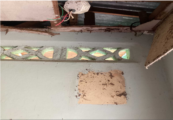
Descripción: INSTALACIÓN ELÉCTRICA Y CIELOS EN MAL ESTADO
