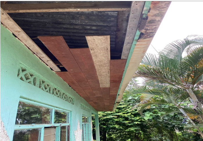
Descripción: CIELOS EN MAL ESTADO
