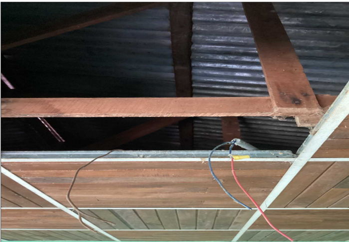
Descripción: INSTALACIÓN ELÉCTRICA EN MAL ESTADO
