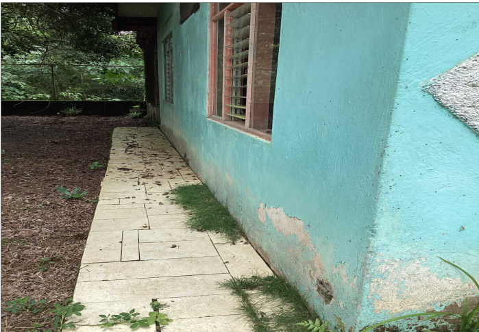
Descripción: PINTURA Y REPELOS MAL ESTADO
