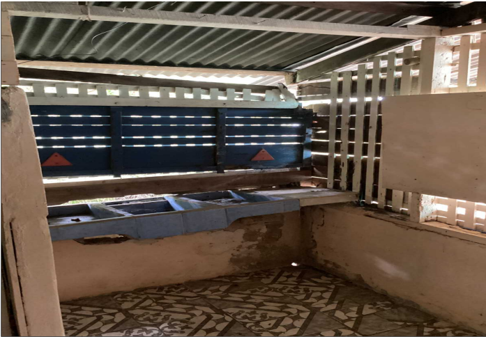
Descripción: PILA EN MAL ESTADO
