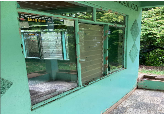
Descripción: VENTANAS EN MAL ESTADO CON COMEJÉN
