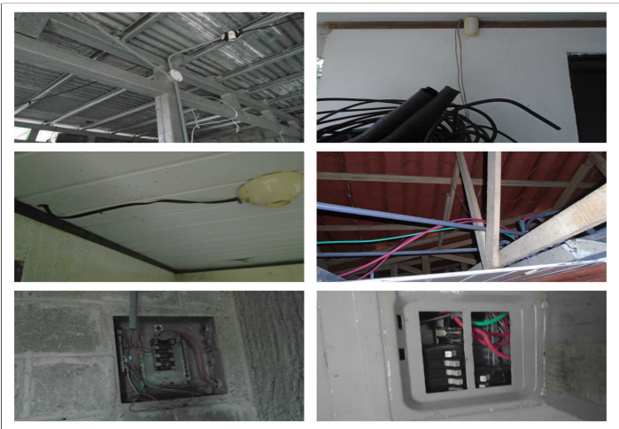
Descripción: Instalación eléctrica
