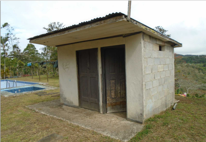
Descripción: Batería de servicios sanitarios de la piscina
