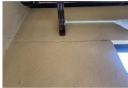
fisuras en repello
