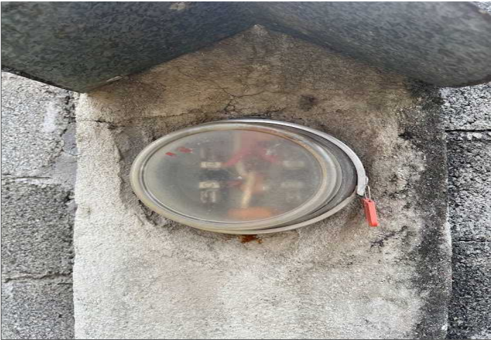
Descripción: MOCHETA DE MEDIDOR NO EXISTENTE
