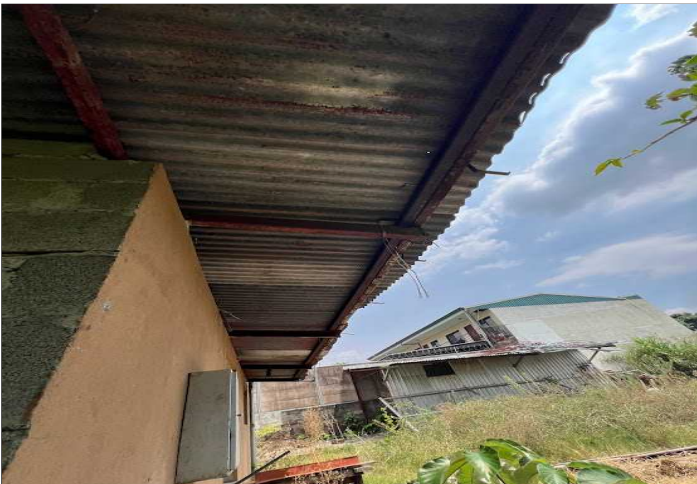
Descripción: CORROSIÓN EN PERFILES DE TECHO Y LÁMINAS HG ONDULADAS DE CUBIERTA - ALER
