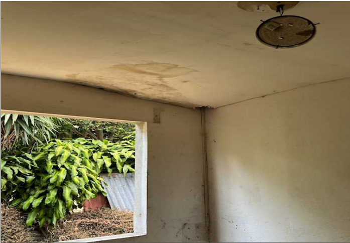
Descripción: DAÑO EN CIELO GYPSUM - DORMITORIO 3
