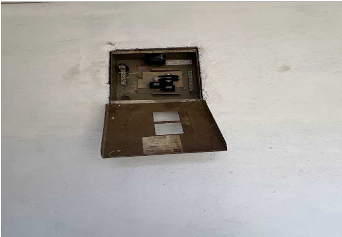
Descripción: CAJAS DE BREAKERS
