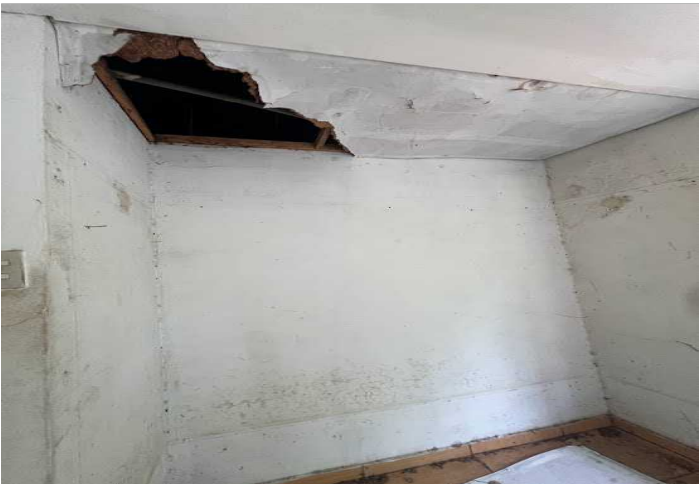
Descripción: DAÑO EN CIELO RASO - DORMITORIO 3
