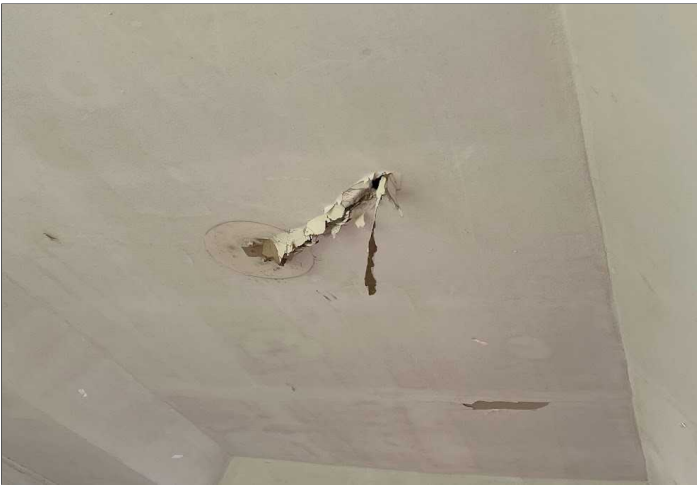
Descripción: DAÑO EN CIELO GYPSUM EN SALA PRODUCTO DE SUSTRACCIÓN DE CABLEADO ELÉC
