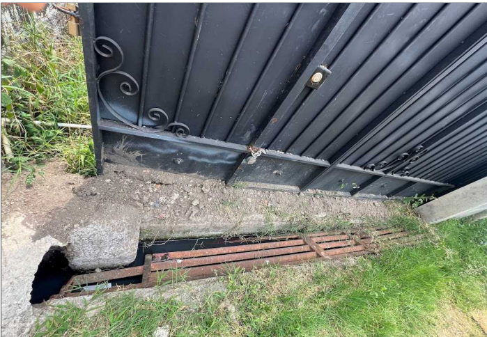
Descripción: OBSTRUCCIÓN DE PORTON Y REJILLA DE INGRESO COLAPSADA
