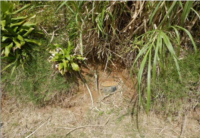
Descripción: Medidor de agua potable frente a la propiedad
