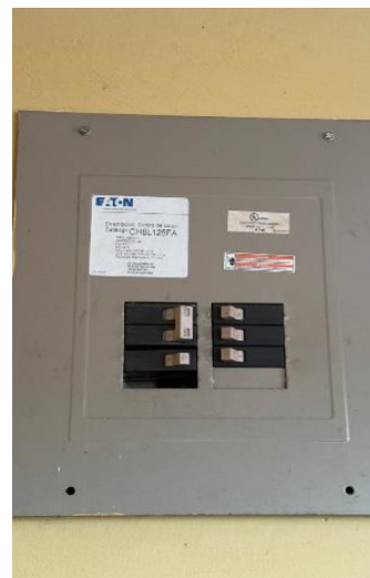
Sistema electrico caja breakers
