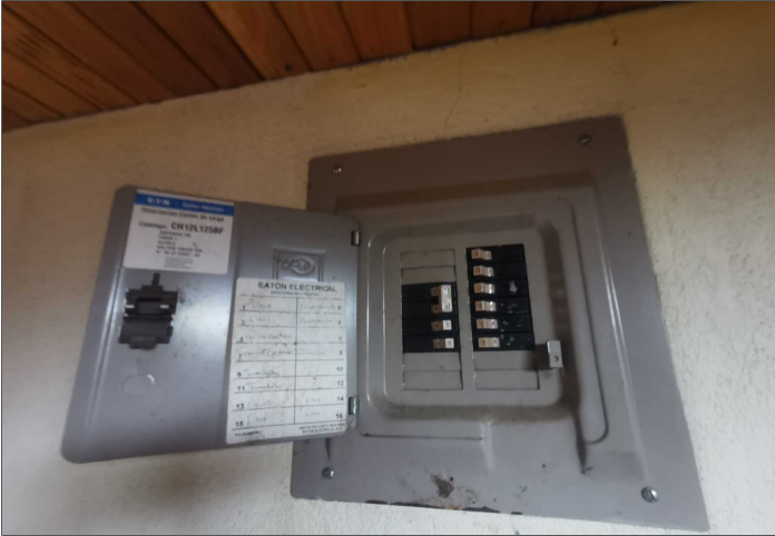
Descripción: CAJA BREAKER
