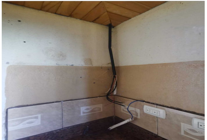
Descripción: CABLEADO SIN ENTUBAR
