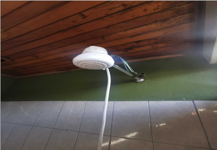
Descripción: CABLEADO TERMODUCHA SIN ENTUBAR
