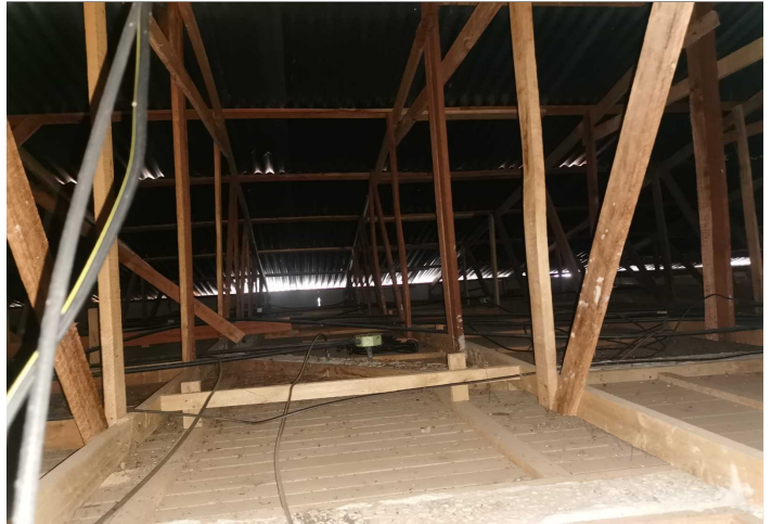
Descripción: SISTEMA ELECTRICO - CABLEADO SIN ENTUBAR
