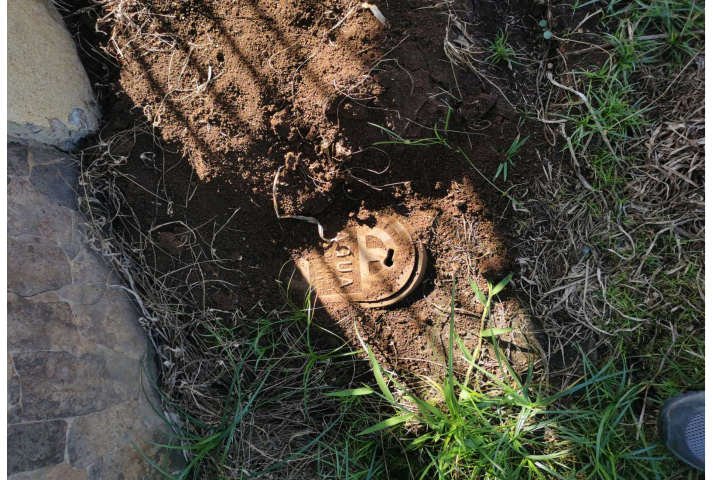
Descripción: SERVICIO DE AGUA ACTIVO
