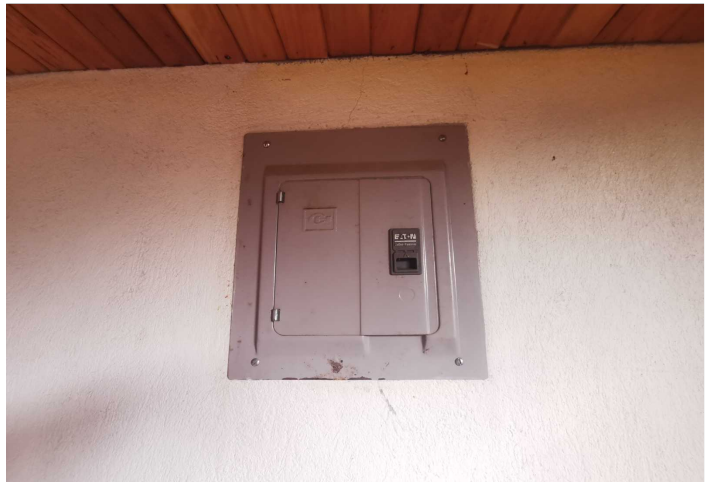
Descripción: CAJA BREAKER
