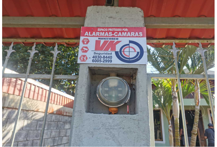
Descripción: SERVICIO ELECTRICO NO ACTIVO - EN LA ZONA EXISTE COBERTURA
