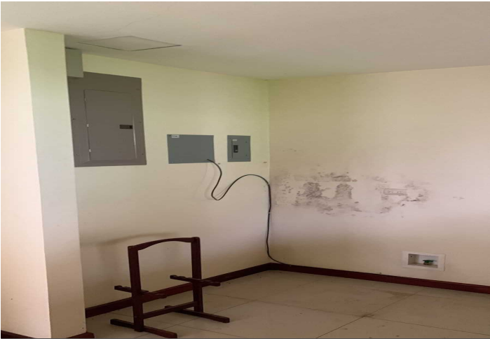
Descripción: Vista interna cuarto pilas
