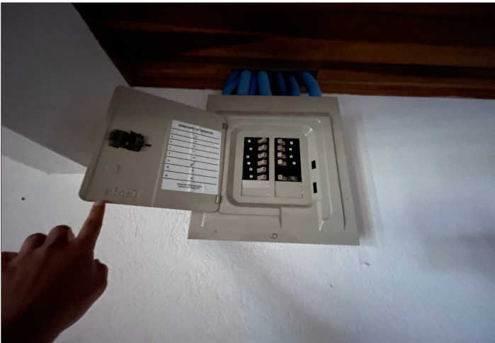
Descripción: Caja de disyuntores
