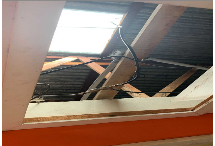
Descripción: Vista rejilla electrica (observa sistema electrico entubado)
