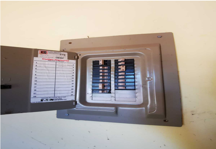
Descripción: CAJA DE BREAKER
