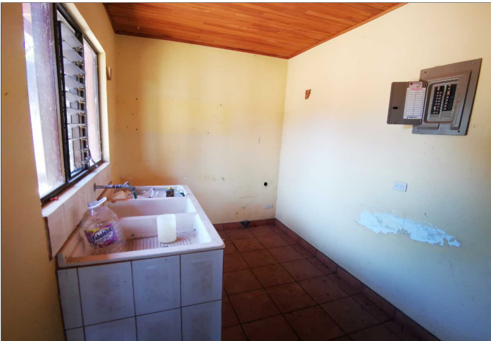
Descripción: CUARTO DE PILAS
