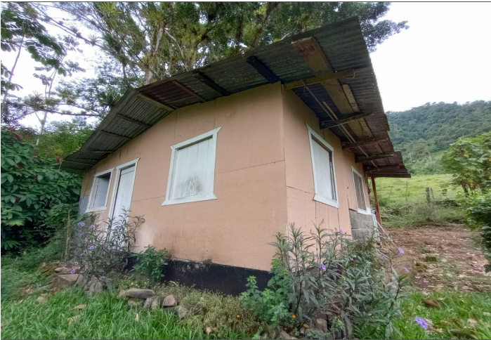
Descripción: Casa de peón en mal estado y abandonada
