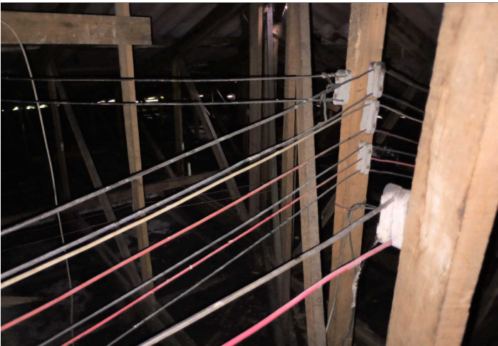
Descripción: Cables de la instalación eléctrica expuestos con aisladores de porcelana
