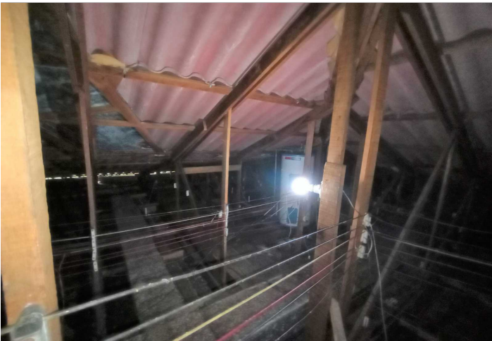
Descripción: Cables de la instalación eléctrica expuestos con aisladores de porcelana. Tanque de agua calien
