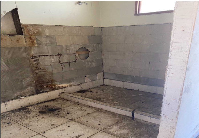
Descripción: ESTADO GENERAL DE BAÑOS EN EDIFICIO
