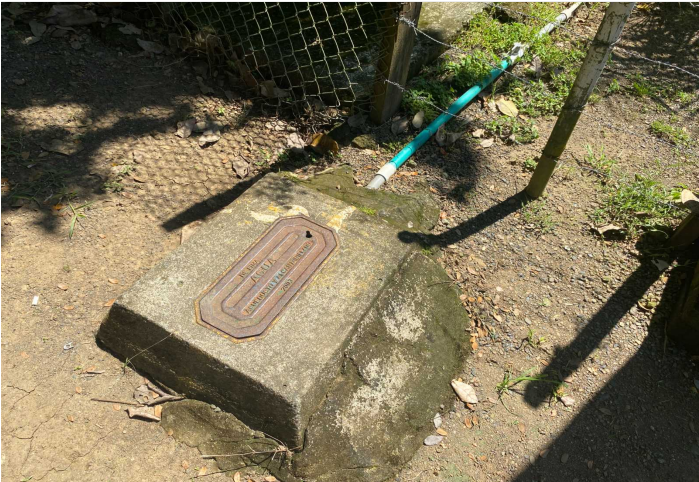
Descripción: MEDIDOR DE AGUA POTABLE INSTALADO AL FRENTE
