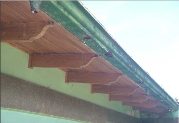
Descripción: Vista del deterioro de canoas y bajantes
