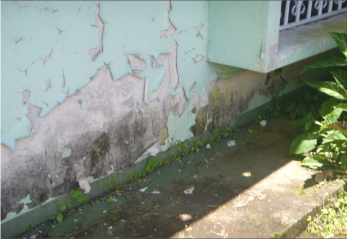
Descripción: Deterioro de paredes externas
