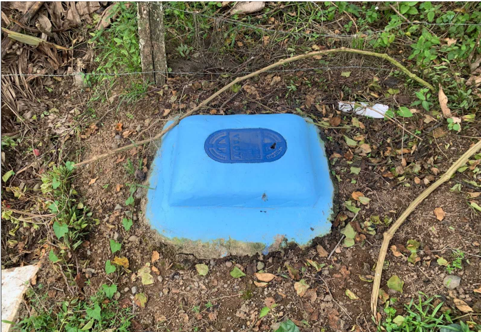
Descripción: Medidor de agua potable
