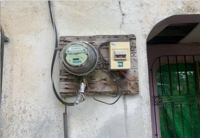
Descripción: Medidor de fluido eléctrico
