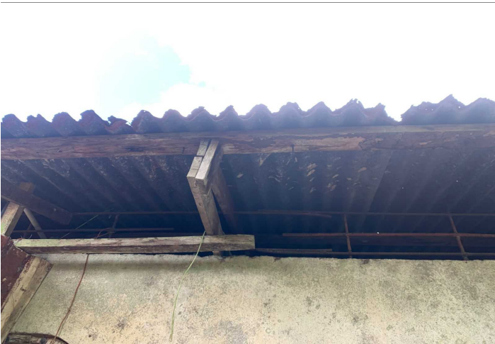
Descripción: Daños en estructura de cubierta
