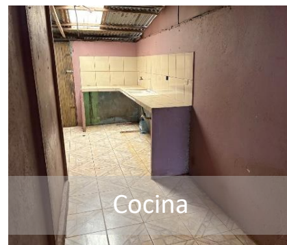
.Sin caja de breakers
